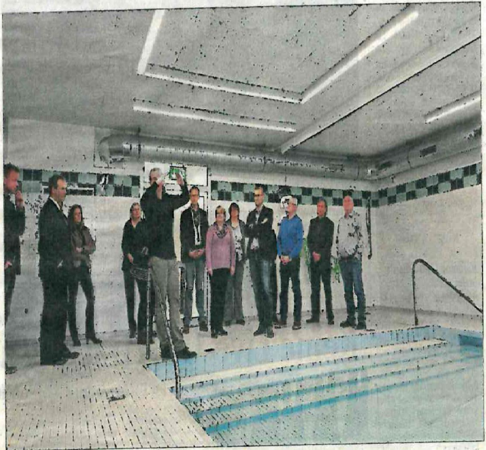
Schulleiter Thomas Janssen (vorne) demonstriert den Mitgliedern des Kreisschulenausschusses im sanierten Therapiebad, wie sich eindringende Feuchtigkeit auf tragende Teile der Deckenkonstruktion ausgewirkt hat.
